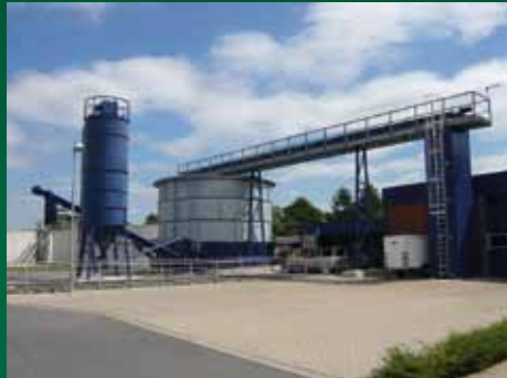
Kläranlage Spenge, 250 cbm Schlammstapel-silo in verzinkter Ausführung, Befüllung durch Spiralfördersystem, Verladeleistung ca. 50 to/h mit optionaler Aufkalkung
