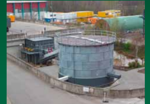
Müllverbrennungsanlage Bremen, Fremdschlammannahme mit 500 cbm Schlammstapelsilo, Direkteintrag über Spiralfördertechnik ca. 50 to/h
