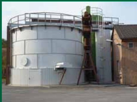
Kläranlage Rollsdorf, 250 cbm Schlammstapel-silo in verzinkter Ausführung, Verladeleistung ca. 50 to/h
