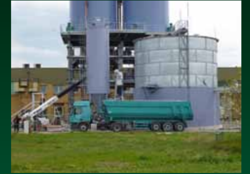
Kläranlage Dresden, 500 cbm Schlammstapel-silo mit optionaler Kalkzugabe während des Verladens
