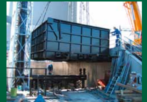
Kraftwerk Ibbenbüren, vormontierte Fremdschlammannahme mit Spiralfördertechnik in Modulbauweise
