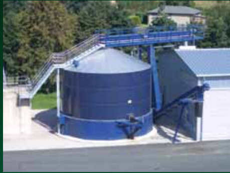
Kläranlage Herford, 250 cbm Schlammstapel-silo in emailierter Ausführung, Befüllung durch Spiralfördersystem, Verladeleistung ca. 50 to/h
